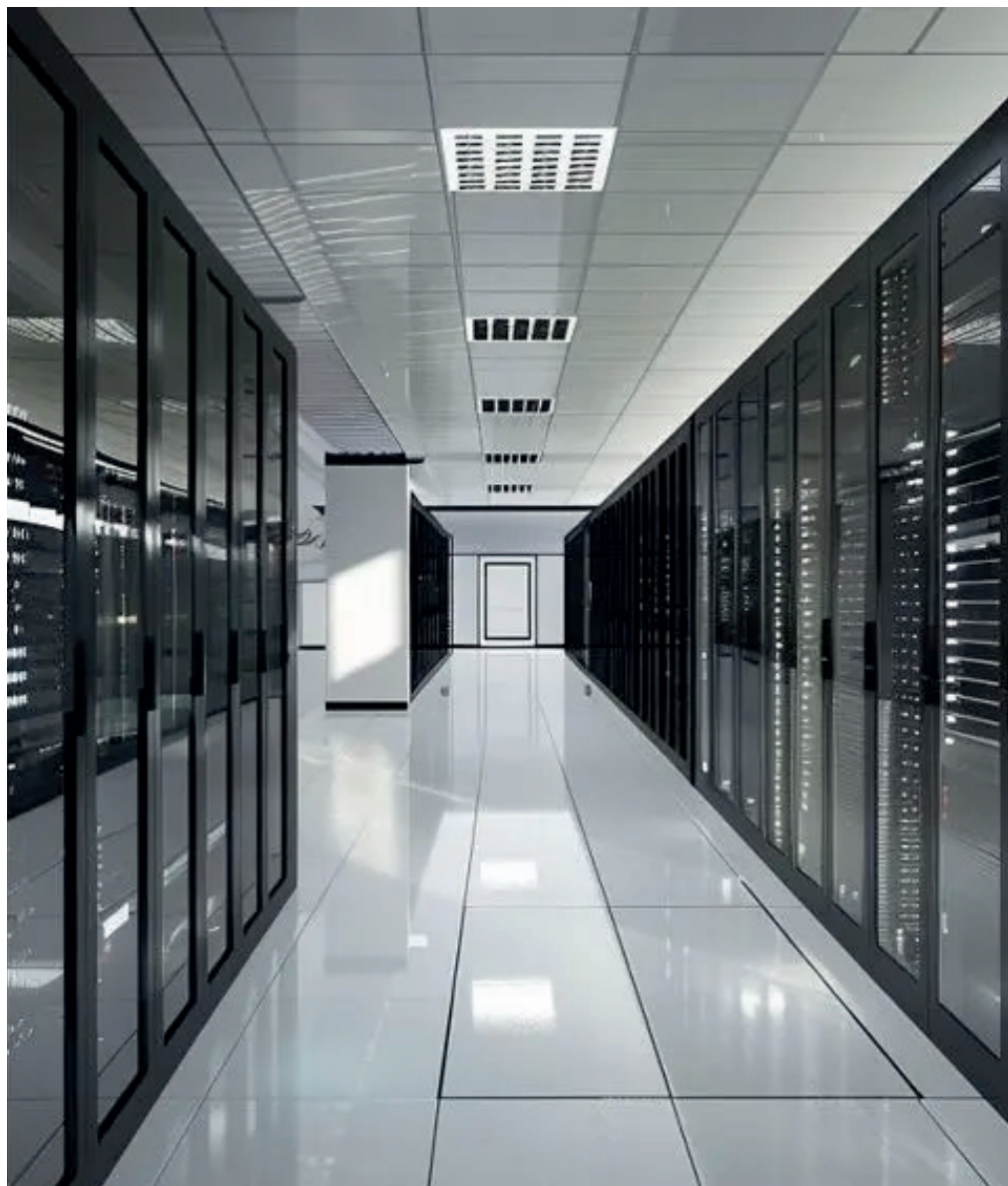
Novo regime prevê benefícios fiscais para empresas que instalem ou ampliem datacenters no País. Foto: Freepik
