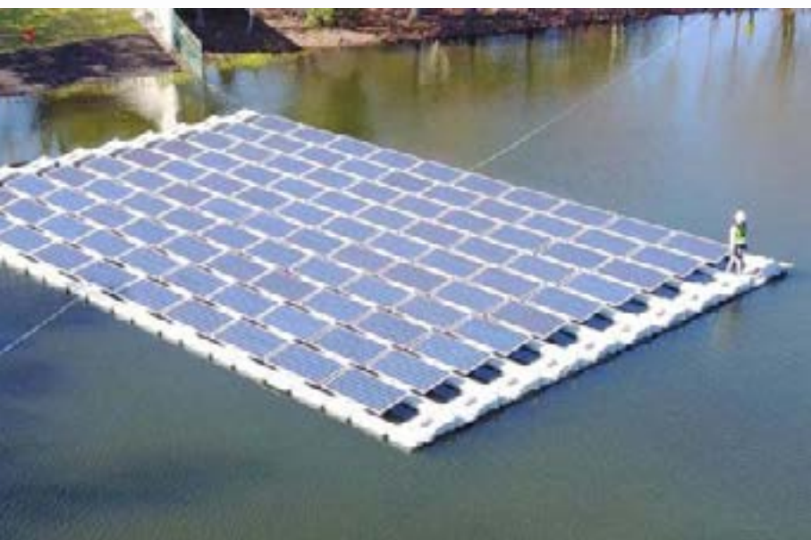
Um dos projetos que estão sendo analisados é a geração de energia em plantas flutuantes. FOTO: DIVULGAÇÃO/GOVERNO DO CEARÁ
